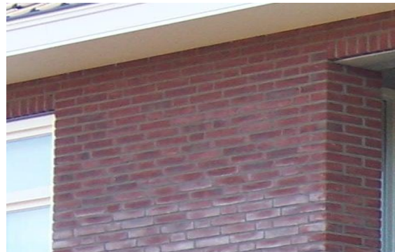
Bestanddelen die vergipsing veroorzaken verplaatsen via poriën in de mortel en steen naar het oppervlak. Water verdampt en gips wordt als uitslag zichtbaar aan het oppervlak.
